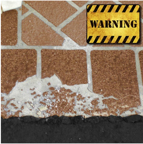
「新設コンクリート」下地の剥がれの現象例
